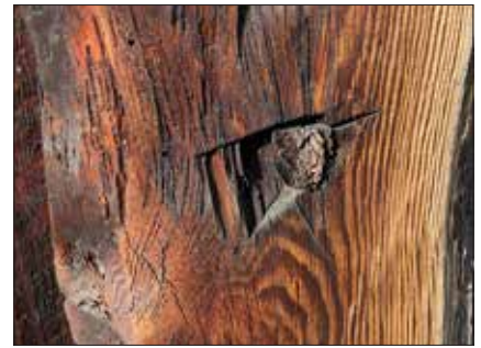
Bordkledninga på Nordhaug, Romsdalsmuseet, er festa med trenaglar. Her er brukt tro-navar for å lage hol. For å få navaren til «å bite» (slik at ein kjem i gang) er det hogge «navarbit» i bordet med hjørnet på ei skarp øks.
