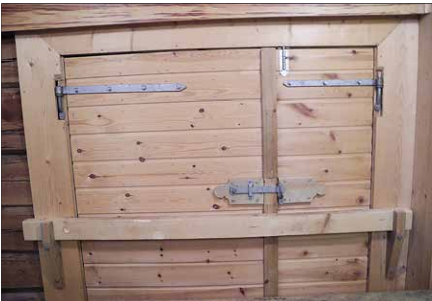
Ny dør med slå på Tingvoll Museum. Dette var eit vanleg stengsel på uthusdører.
